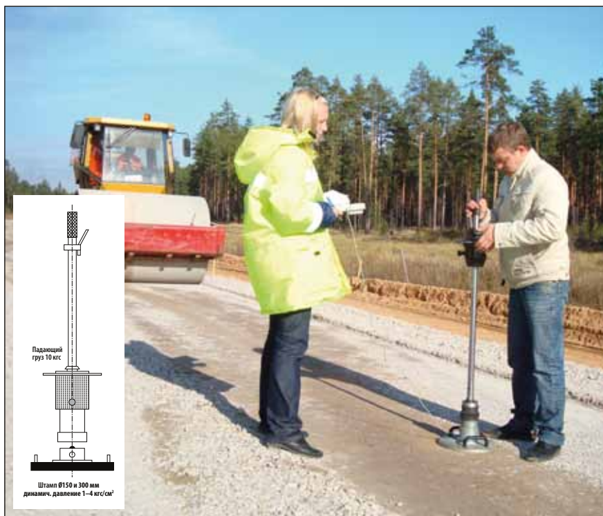
Рис. 2. Установка ударного нагружения (УДН) малогабаритная переносная для измерения динамического модуля деформации грунта и щебня
