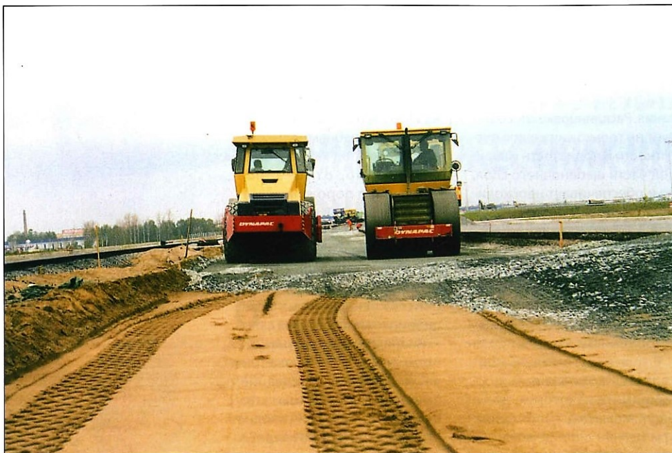
Рис. 1. Одновальцовый виброкаток СА302D (слева) и трехвальцовый статический каток CS141/142 (справа) фирмы Дупарас на устройстве щебеночного основания кольцевой автомобильной дороги (КАД) Санкт-Петербурга.
