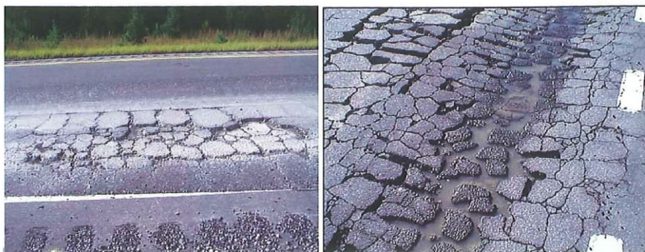
Рис. 1. Усталостное растрескивание в виде «крокодиловой кожи»
